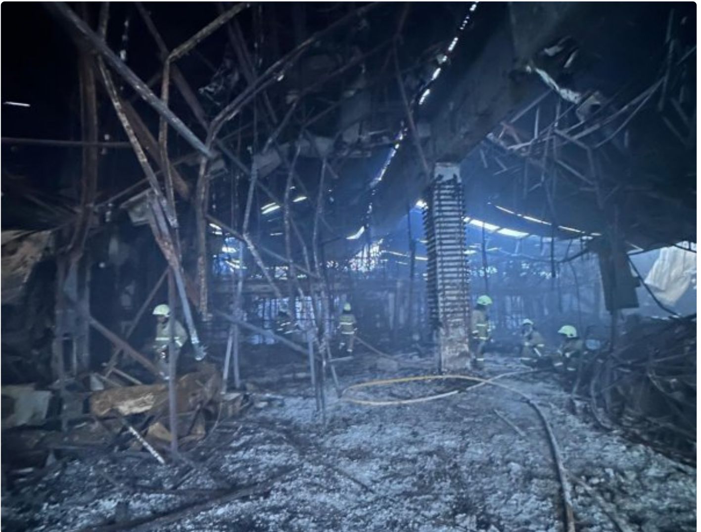
Glodok Plaza yang Hangus Terbakar
